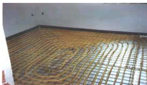
Obr. 5 RTI v podlahové konstrukci topení
