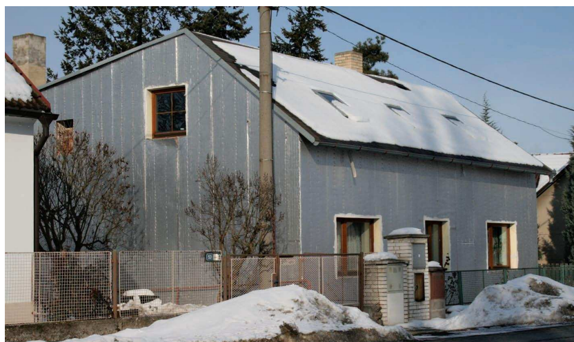
Obr. 1: Dům v Kojeticích. Reflexní tepelněizolační fólie, která je výrobcem určena pro vnitřní použití, je umístěna na venkovní straně a proti všem pravidlům je nechráněná fasádní předstěnou. Její tepelněizolační účinky jsou citelně oslabeny.
