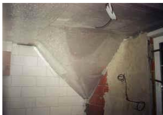
Obr. 18 Detail upevnění RTI ke stěně.
